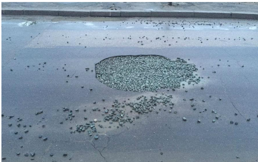
Рисунок 1 – Нарушение технологий при строительстве дорог
